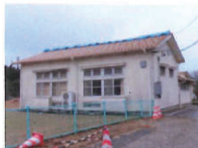
図9. T保育所の屋根損傷
