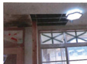
図10. 雨漏りによる天井の損傷
