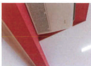
図7. 遊戯室の壁の破損
