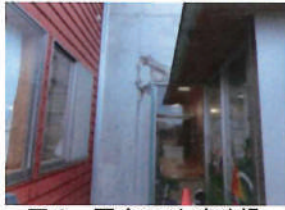
図 3. 園舎の外壁破損
