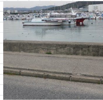
防波堤にみられるひび割れ (写真提供 岡山大学 藤井隆史准教授)
