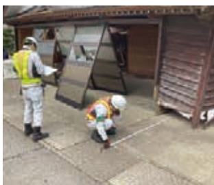
倒壊した家屋の調査
