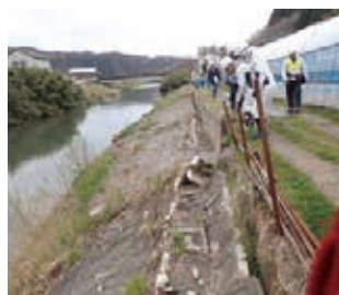
被災した河川護岸の調査
