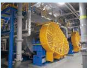
堆肥化(発酵)装置
