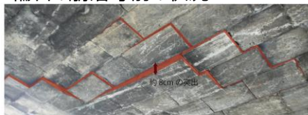
輪石の崩落寸前の状況
